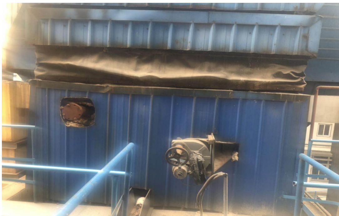
图 5-2 布袋除尘后检测口
