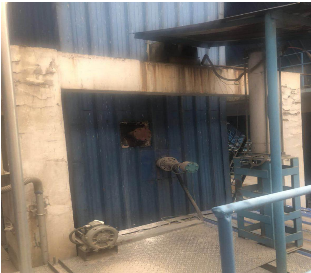
图 5-1 布袋除尘前检测口
