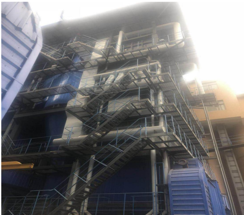
图 2-7 锅炉脱硝装置
